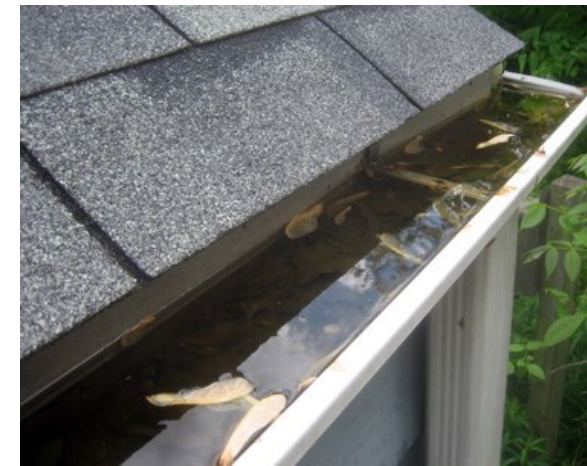
pluviali dei tetti
